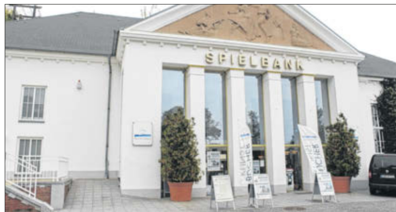
In die Ex-Spielbank an der Promenade soll bis zum Frühjahr ein moderner Event-Store einziehen. Die Arbeiten haben schon begonnen.
